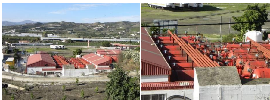
Figura 78: Estación potabilizadora de El Trapiche.
