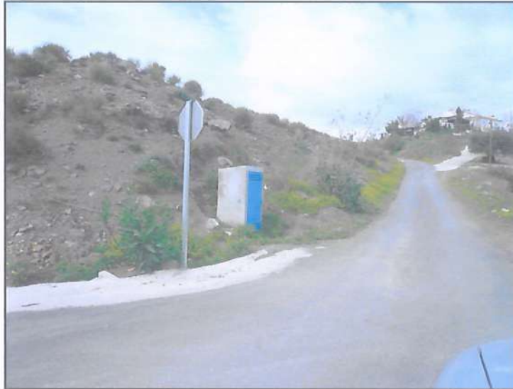
Armario de acometida de agua.
