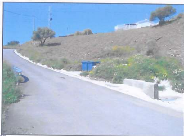
Foto 6: Vista del sumidero de recogida de aguas Superficiales en la vía pecuaria
