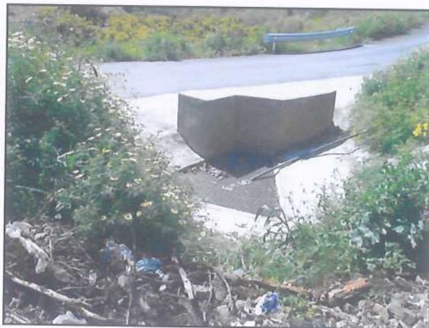
Foto 16: Colector de drenaje superficial bajo la vía pecuaria
