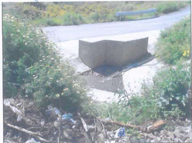
Foto 16: Colector de drenaje superficial bajo la vía pecuaria
