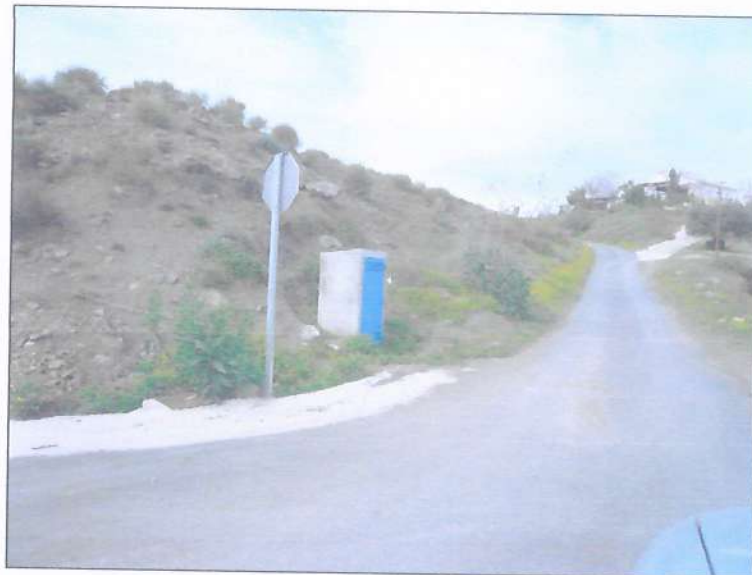
Armario de acometida de agua.
