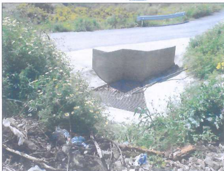
Colector de drenaje bajo la vía pecuaria
