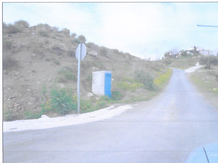
Armario de acometida de agua.
