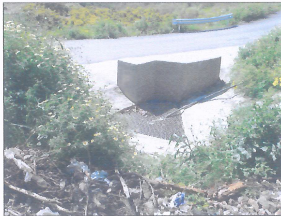
Colector de drenaje bajo la vía pecuaria
