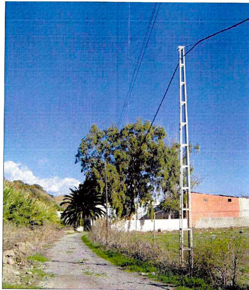
LE/F3 - LINEA ELECTRICA.
