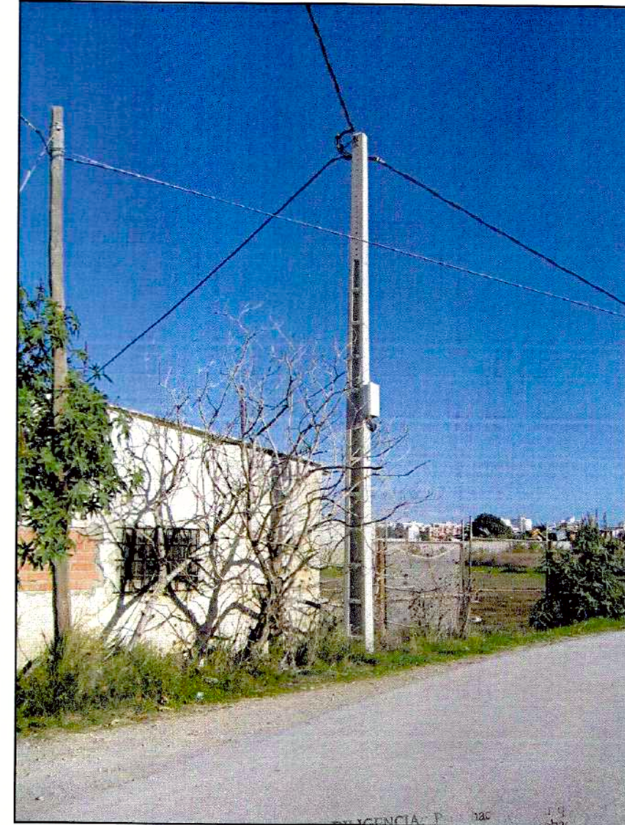
LE/F2 - LINEA ELECTRICA.
