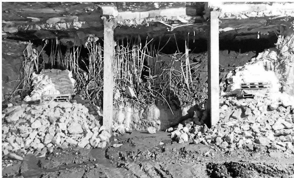
Imagen de los daños causados en el interior del túnel del Metro en Callejones del Perchel.
